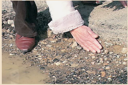
ぽっかり空いた大穴の段差は手のひら分。危険だ!!
